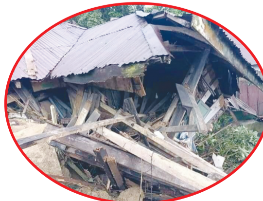
Rumah warga yang hancur di terjang tanah longsor.
